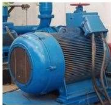
Gambar 4. Elektromotor pada Pompa Sentrifugal
