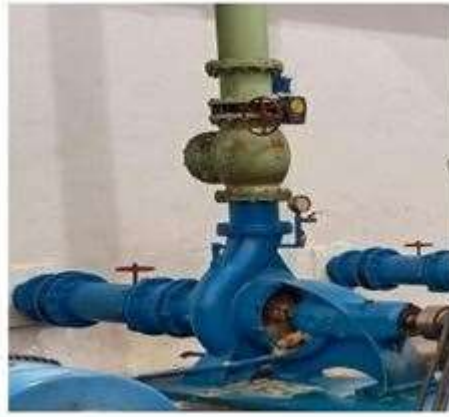
Gambar 3. Pompa Sentrifugal pada Finish Water Pump (FWP)
