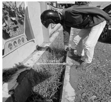
Gambar 3 : Kondisi Drainase Segmen 1
