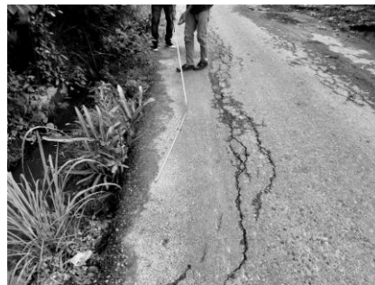
Gambar 3: Kondisi Jalan Pada STA 0+200 - 0+250
