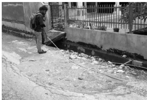
Gambar 2: Kondisi Jalan Pada STA 0+000 - 0+050
