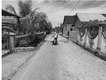
Gambar 8: Kondisi jalan pada STA 0+050 - 0+100
