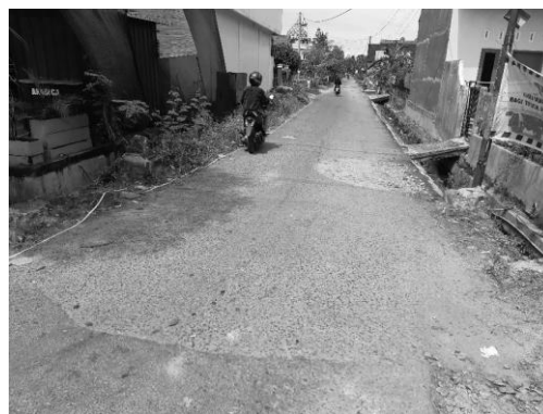
Gambar 6: Kondisi jalan pada STA 0+000 - 0+050
