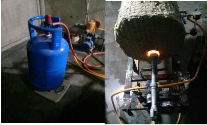
Gambar 9 Instalasi LPG dan Burner (Sumber: Dokumentasi pribadi, 2020)
