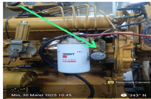
Gambar 10: Pompa injeksi tekanan tinggi
