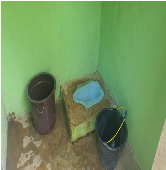
Gambar 3. Saluran pipa air bersih belum ada ke WC
