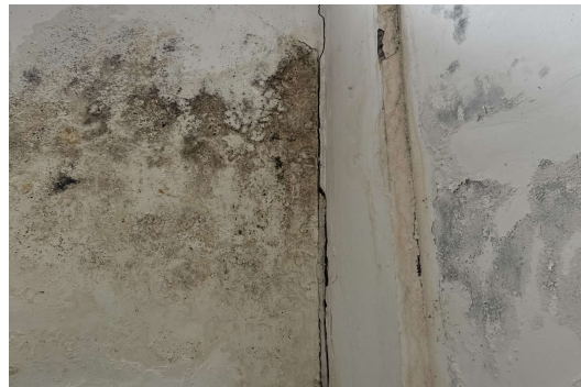
Gambar 2. Kondisi dinding berjamur pada SDN 067775 Medan
