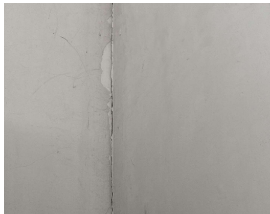
Gambar 3. Kondisi dinding retak dan cat mengelupas pada SDN 067775 Medan
