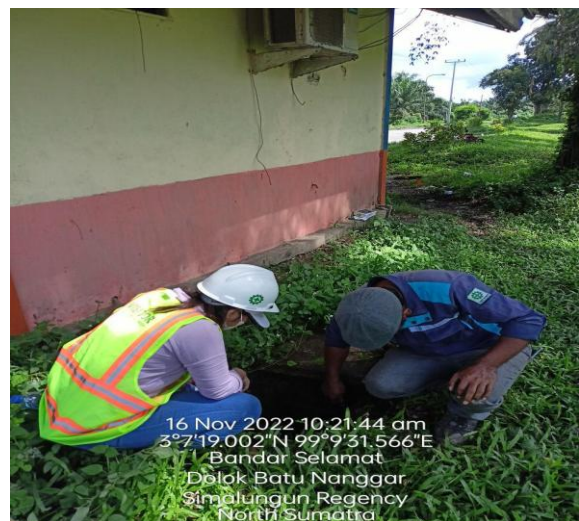
Gambar 6. Hasil pengecekan grounding box di Jembatan Timbang 40 dan 50 ton
