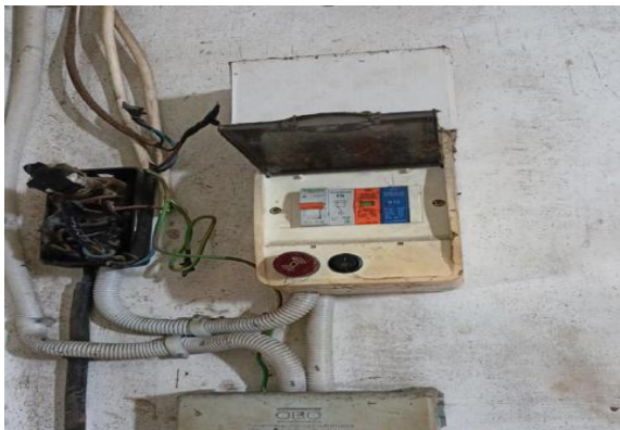
Gambar 8. Sistem proteksi internal di Jembatan Timbang 40 dan 50 ton.
