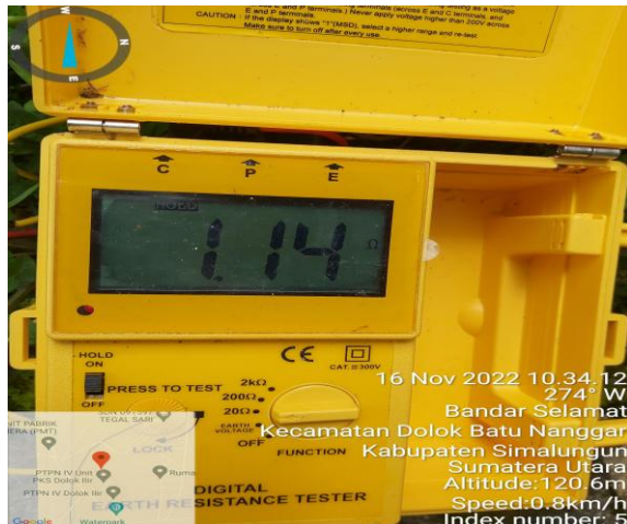
Gambar 7 . Hasil pengukuran nilai tahanan grounding di Jembatan Timbang 40 dan 50 Ton
