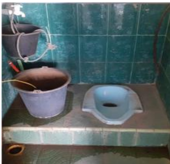
Gambar 3. WC yang menggunakan air sumur untuk penyiramannya
