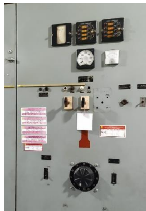
Gambar 3. Panel Kontrol Eksitasi
