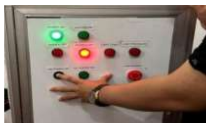
Gambar 7. Hasil Pengujian Pompa On Pada Panel
