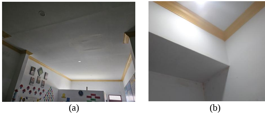
Gambar 6. Kondisi Plafond Setelah Kegiatan
