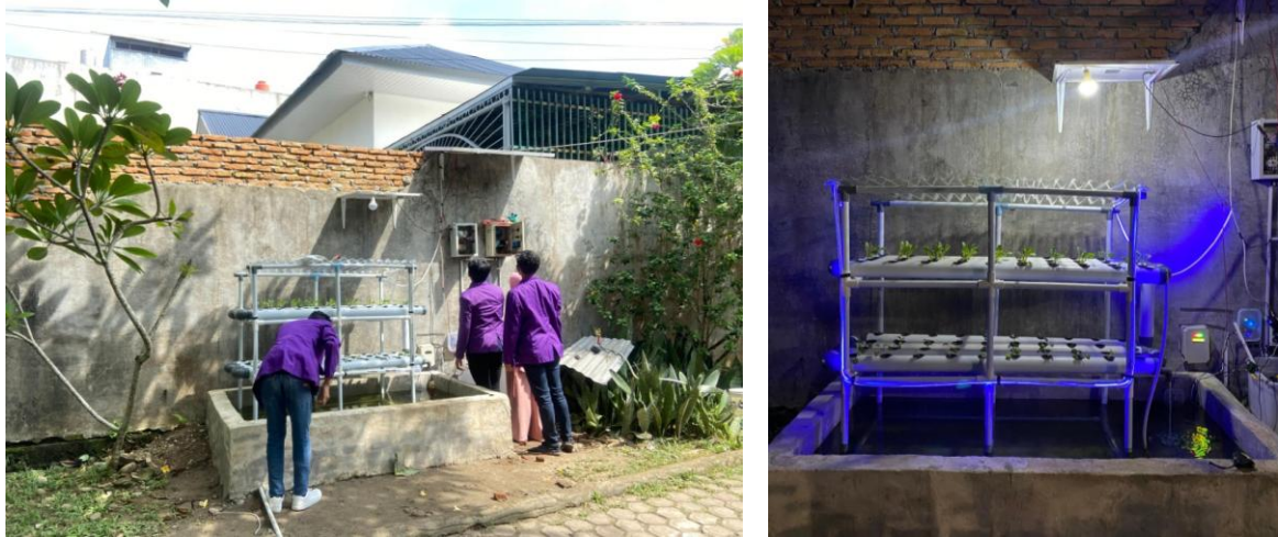
Gambar 5. Hasil pemasangan Akuaponik dengan sumber Kombinasi Panel surya dan Mikrohidro
