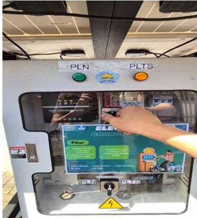
Gambar 5. Pengujian system ATS
